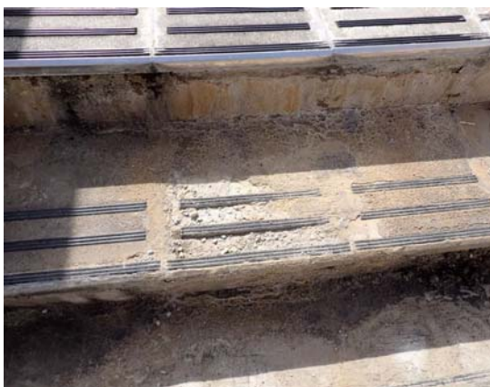
踏み板：剥離(スケリング)（Ⅱ）
