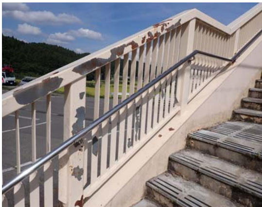
高欄：防食機能の劣化（Ⅱ）
