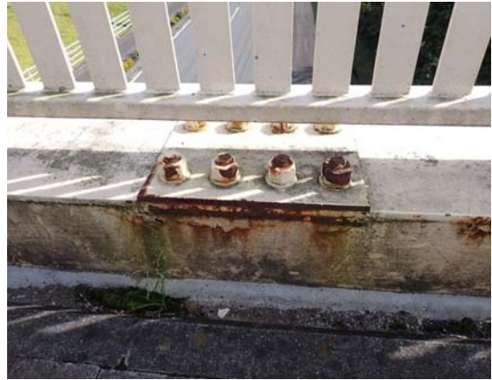
主桁・地覆：腐食（Ⅱ）
