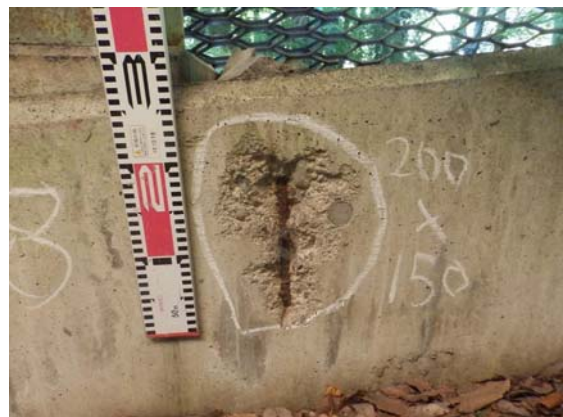
受台：剝離・鉄筋露出（Ⅱ）
