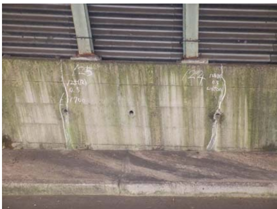
受台：ひび割れ（Ⅱ）
