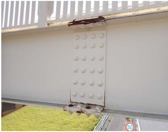
主桁：腐食（Ⅱ）
