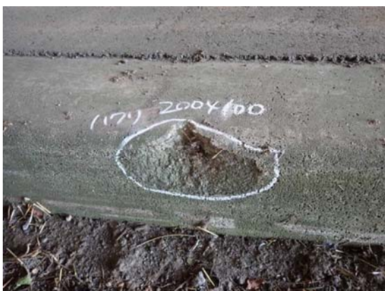
縁石：剥離（Ⅱ）
