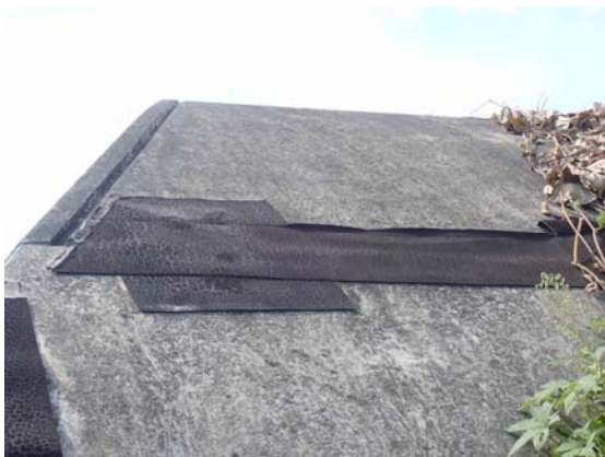
頂版：止水シートの劣化（Ⅰ）
