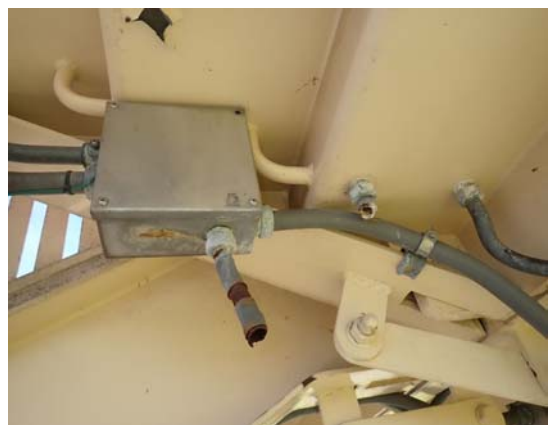
融雪装置：腐食，破損（Ⅱ）
