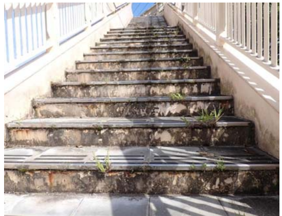
蹴上げ：腐食（Ⅱ）
