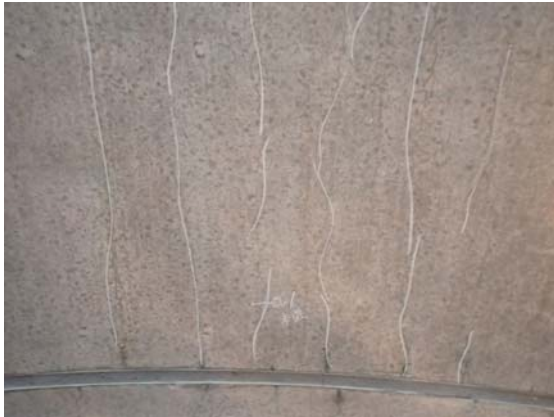
頂版：ひび割れ（Ⅰ）
