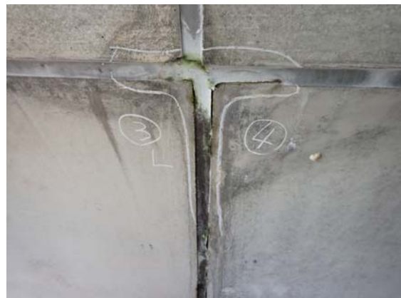
側壁：目地の漏水（Ⅰ）
