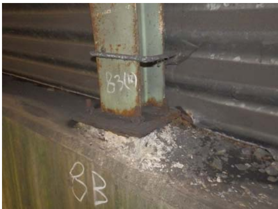
支承部(主梁基部)：腐食（Ⅲ）
