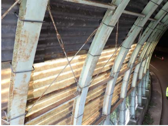
主梁：防食機能の劣化（Ⅱ）
